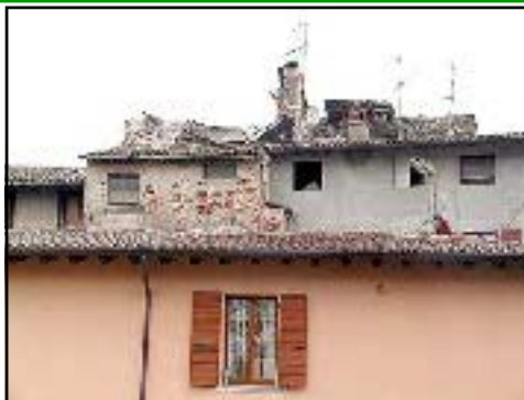
▲ un tetto crollato in Via "Rive"
