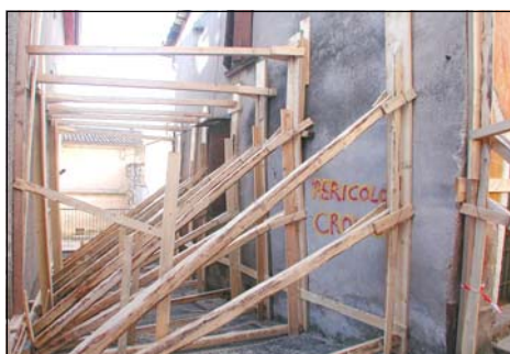
▲ Un fabbricato danneggiato
